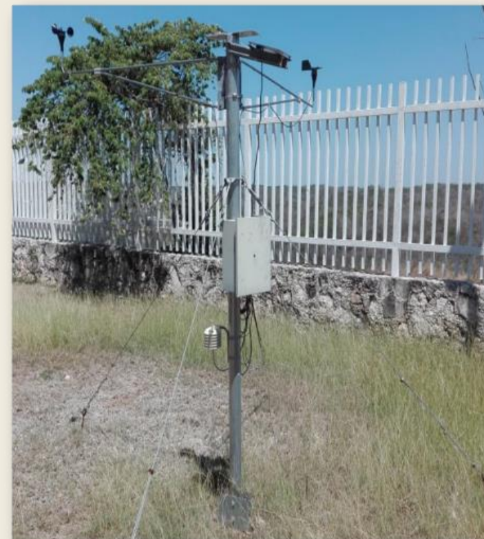
Ilustración 4: Estación meteorológica instalada en la facultad de ingeniería
