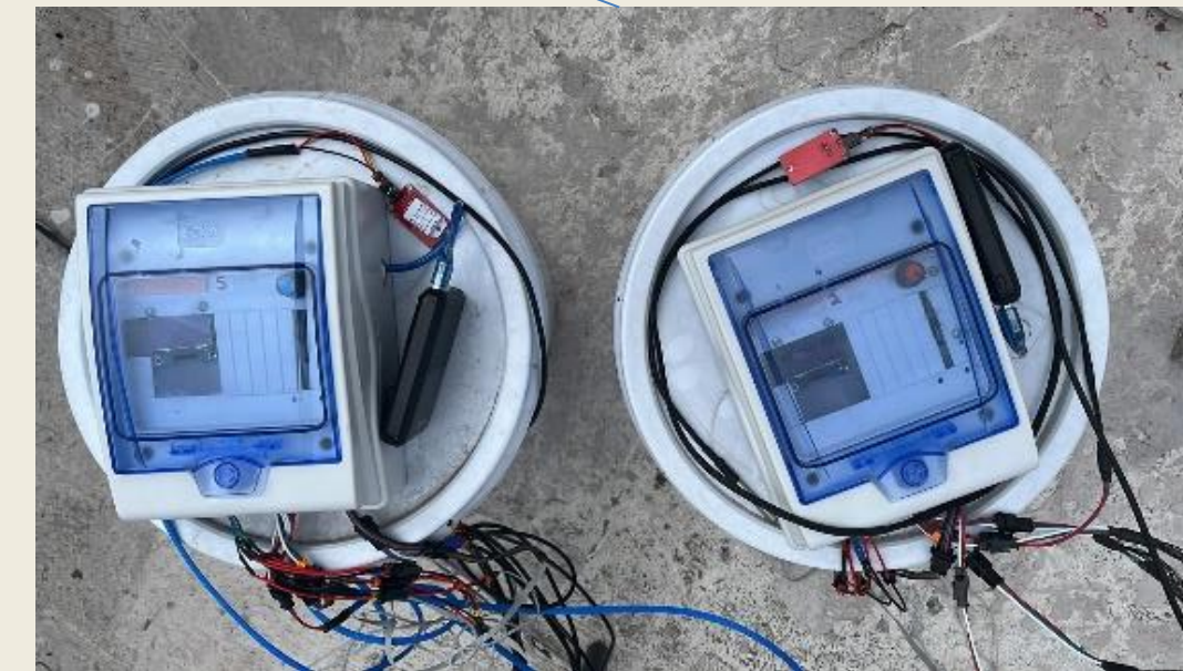
Ilustración 3: Sistema de monitoreo del secador solar
